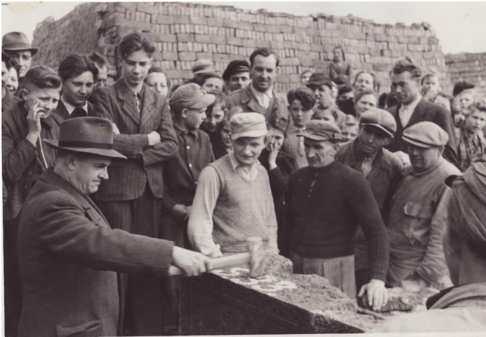
Bürgermeister Eckhardt legt den Grundstein für die neue Schule. Im Hintergrund sieht man schon die fertigen Ziegelsteine
