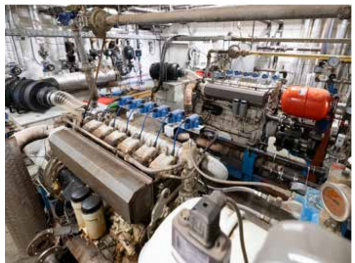
Blockheizkraftwerkraum mit den ersten beiden Motoren
